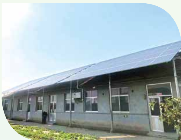
沐浴店镇镇级光伏项目
